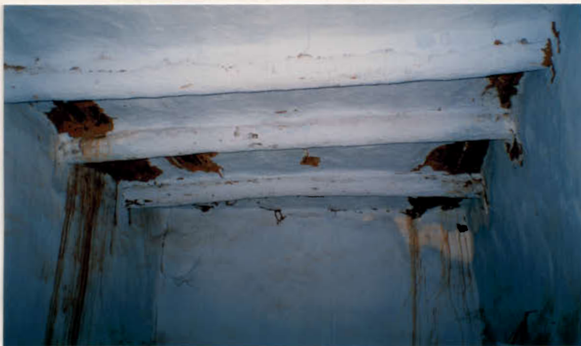
Bâtiment 3 - des morceaux de plafond tombés
